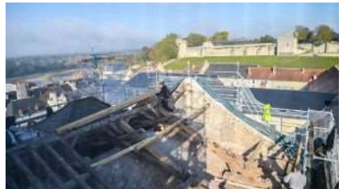
Vue de la restauration de la charpente de l'église du prieuré de La Charité sur Loire
